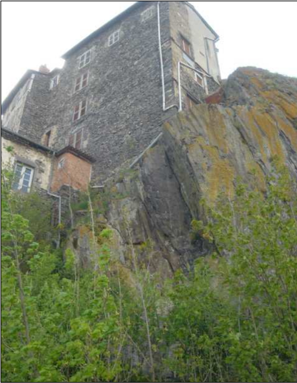
Pan de falaise à renforcer – vue du pied (source LRPC, prise de vue mai 2010)
