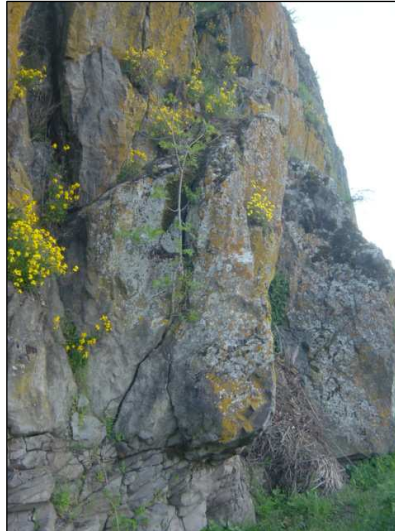
Arbrisseau croissant au sein d'une discontinuité (source LRPC, prise de vue mai 2010)
