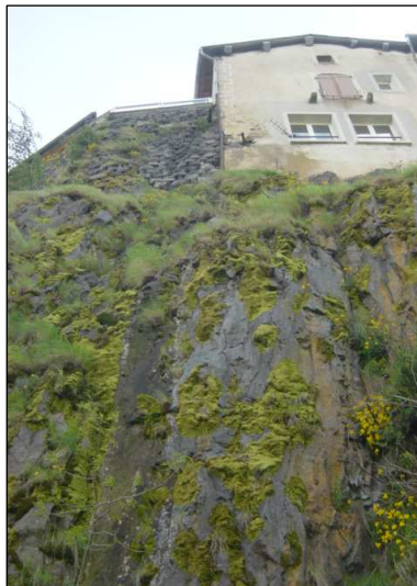
Trace d'écoulement d'eau sur la falaise (source LRPC, prise de vue mai 2010)
