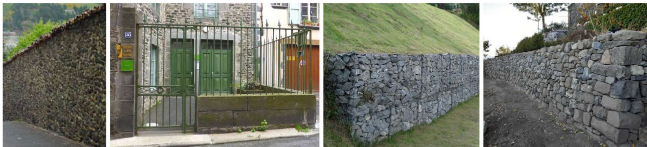
Exemples de murs en en pierres locales couvert en tuile, mur bahut avec grilles ajourées, gabion et pierres sèches
