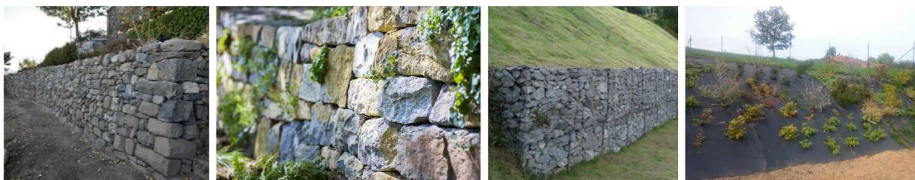
Exemples de traitement des talus : mur de pierres sèches, enrochement, gabion de pierres locales, talus végétalisé
