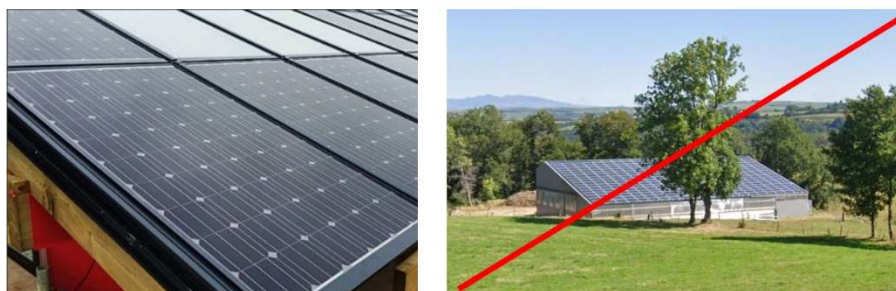
Teinte des panneaux et structures photovoltaïques
