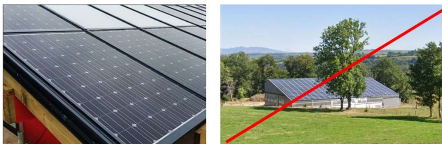
Teinte des panneaux et structures photovoltaïques
