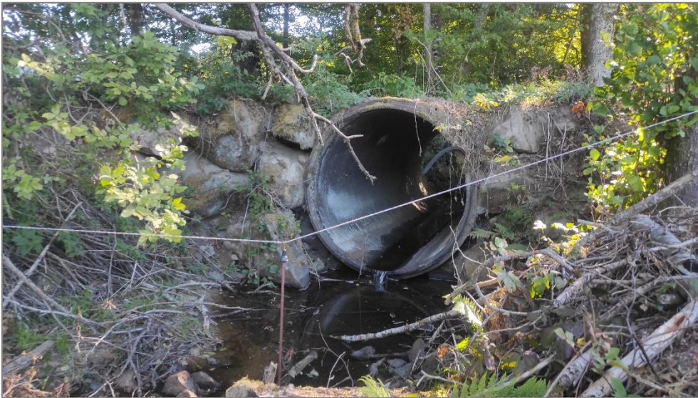
Figure 230 : Buse mal calibrée
