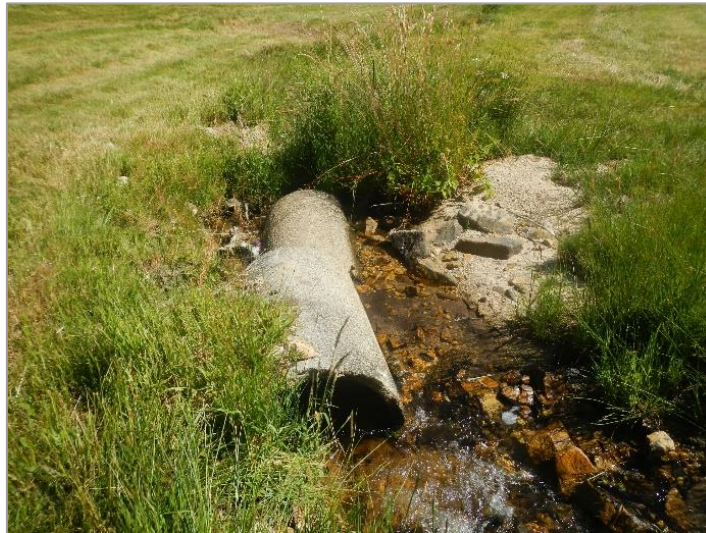
Figure 65 : Buse mal calibrée sur le Remontalou
