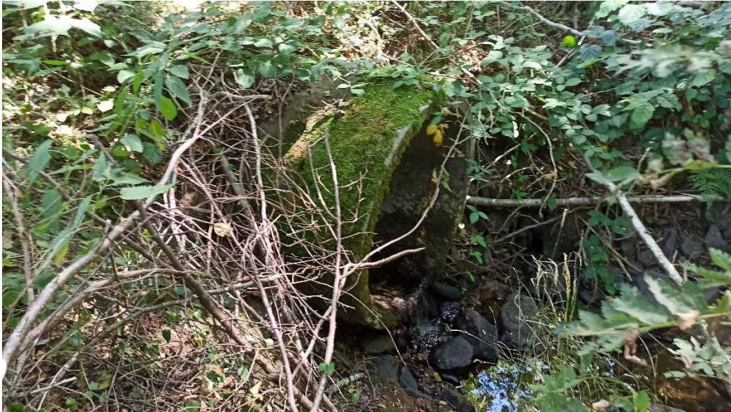
Figure 210 : Buse mal calibrée
