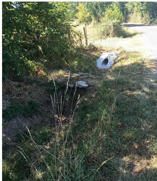
Figure 193 : Fossé de récupération des eaux pluviales le long de la route D34
