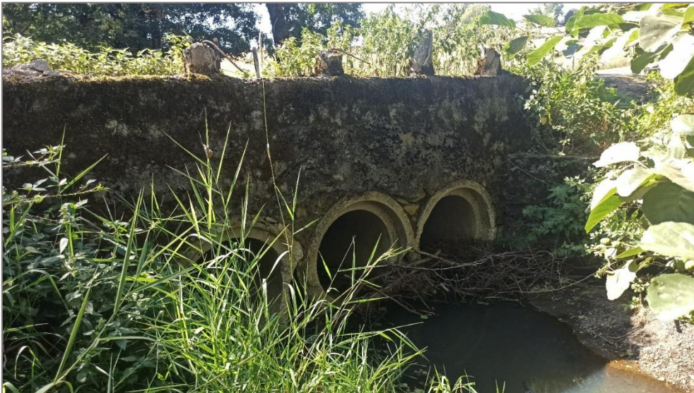
Figure 164 : Passage busé mal calibré sur le Cantoinet
