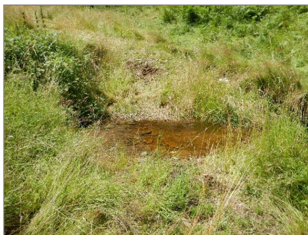
Figure 44 : Passage à gué dégradé
