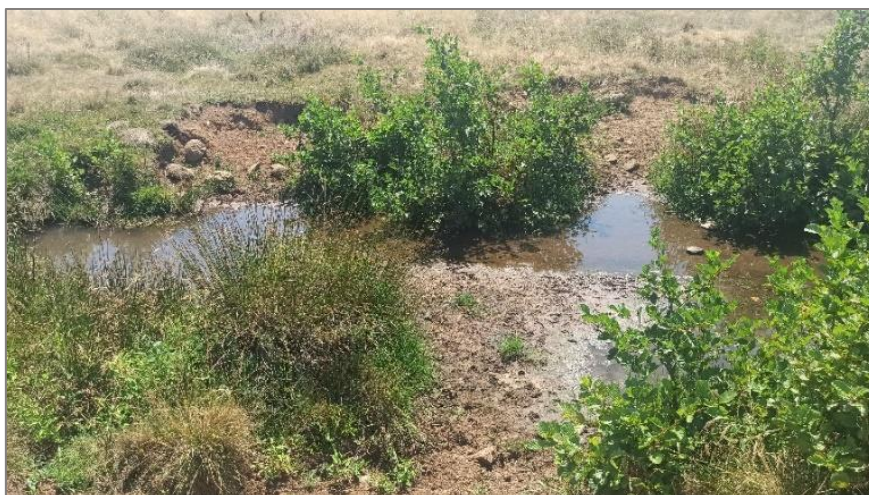
Figure 158 : Passage à gué dégradé
