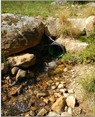
Figure 103 : Buse mal calibrée
