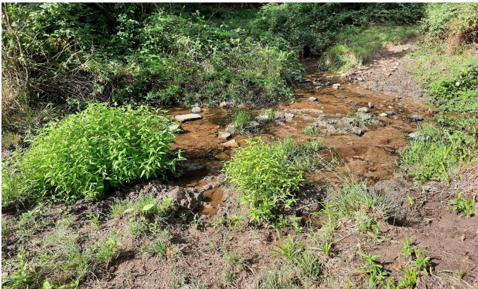
Figure 245 : Passage à gué dégradé
