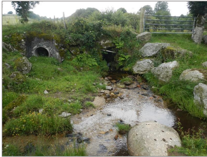
Figure 126 : Buse mal calibrée
