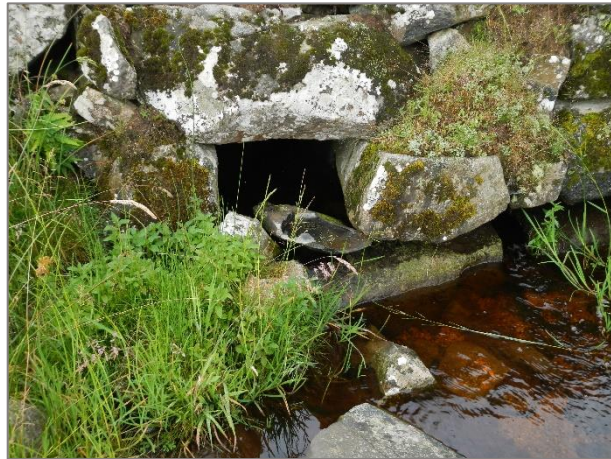
Figure 104 : Muret perturbant l'écoulement
