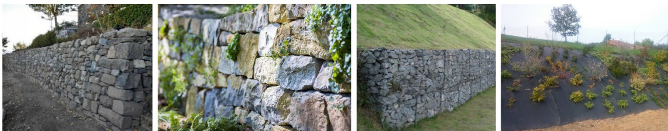
Exemples de traitement des talus : mur de pierres sèches, enrochement, gabion de pierres locales, talus végétalisé
