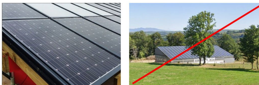
Teinte des panneaux et structures photovoltaïques
