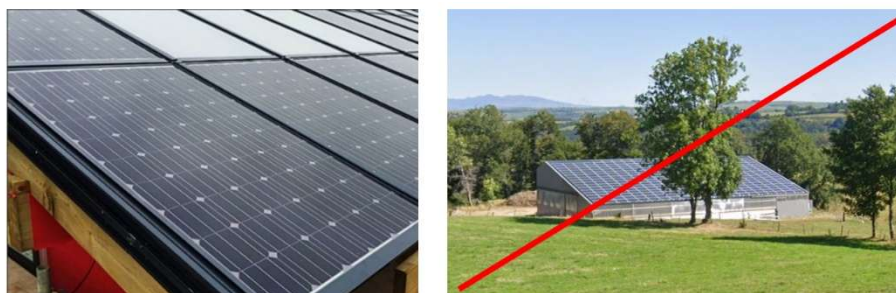
Teinte des panneaux et structures photovoltaïques
